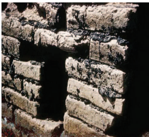
Obr. 01 Historické zdivo „izolované“ přírodním asfaltem. Shell, 1995.
