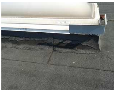
Obrázek F 04 Stékající asfaltová hmota na konstrukci světlíku, orientace J. Zdroj: [vlastní].
