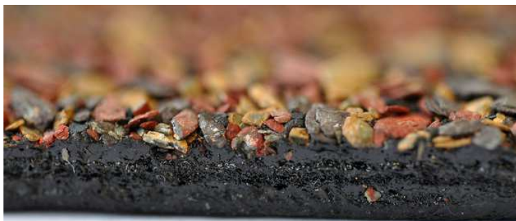
Obr. 05 Řez asfaltovým pásem, na horním povrchu asfaltové krycí vrstvy hrubozrnný minerální posyp. V řezu je zřetelná nosná vložka. Zdroj: [vlastní].
