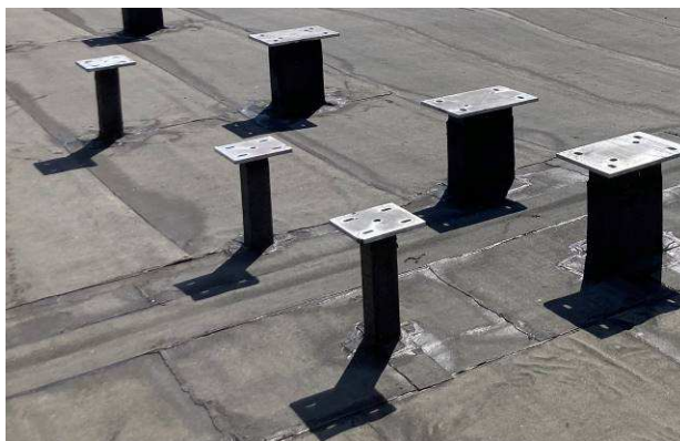
Obr. 23 Obdélníkové uzavřené profily s vhodným odstupem umožňují spolehlivé opracování asfaltovým pásem. Zdroj: [vlastní].
