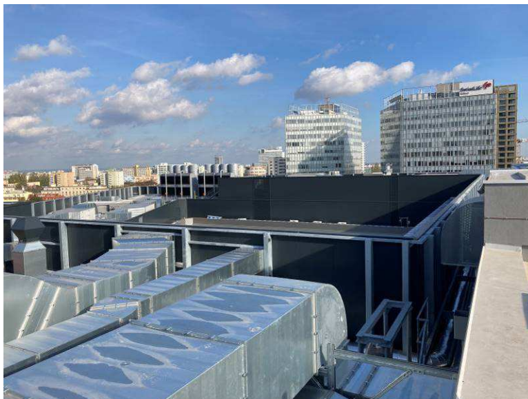
Obr. 22 Příklad velkého množství technologického zařízení na střeše Zdroj: [vlastní].
